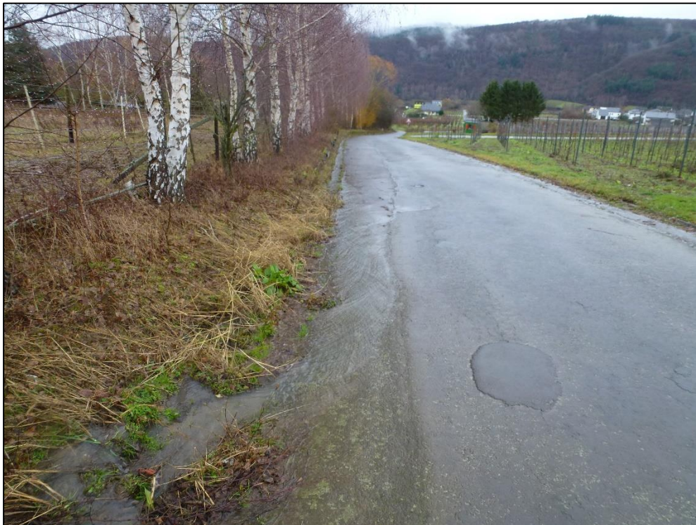
Abbildung 68: Bewuchs in der Rinne verhindert geführte Ableitung des Oberflächenwassers
