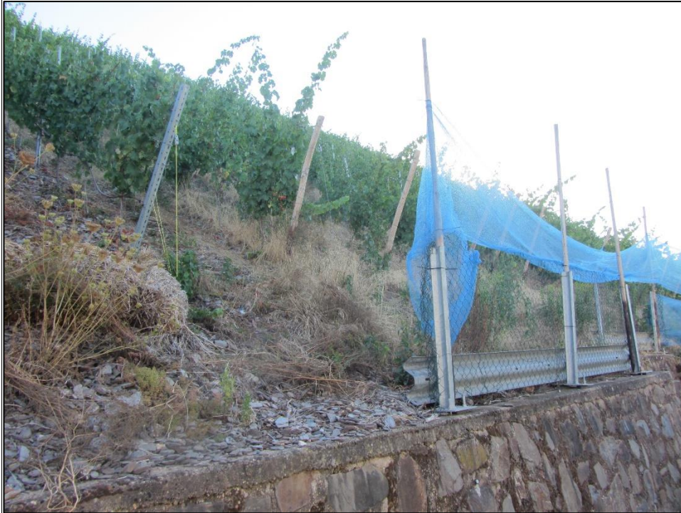
Abbildung 47: Provisorisch angelegter Geröllfang am "Ortsrandweg"
