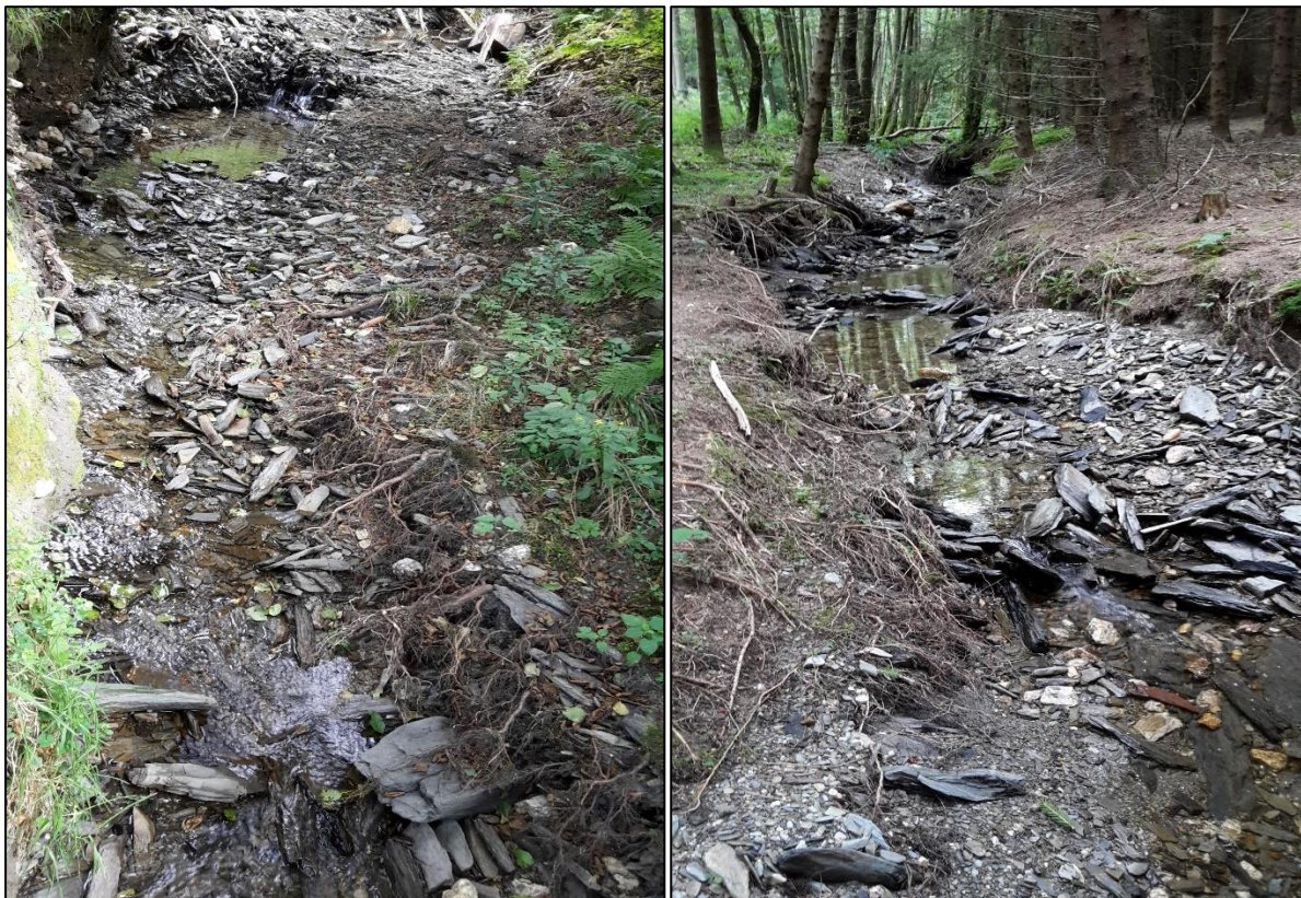
Abbildung 09: Impressionen der Schäden im Außengebiet
