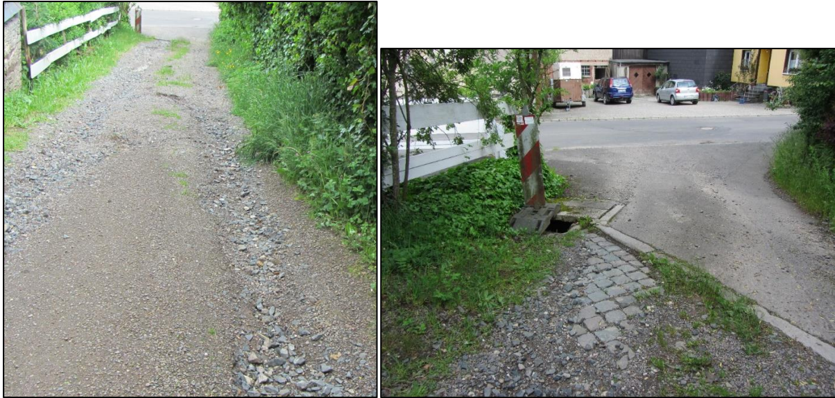
Abbildung 41: Erosionsrinnen (links) und Entwässerungssystem (rechts) am Verbindungsweg
