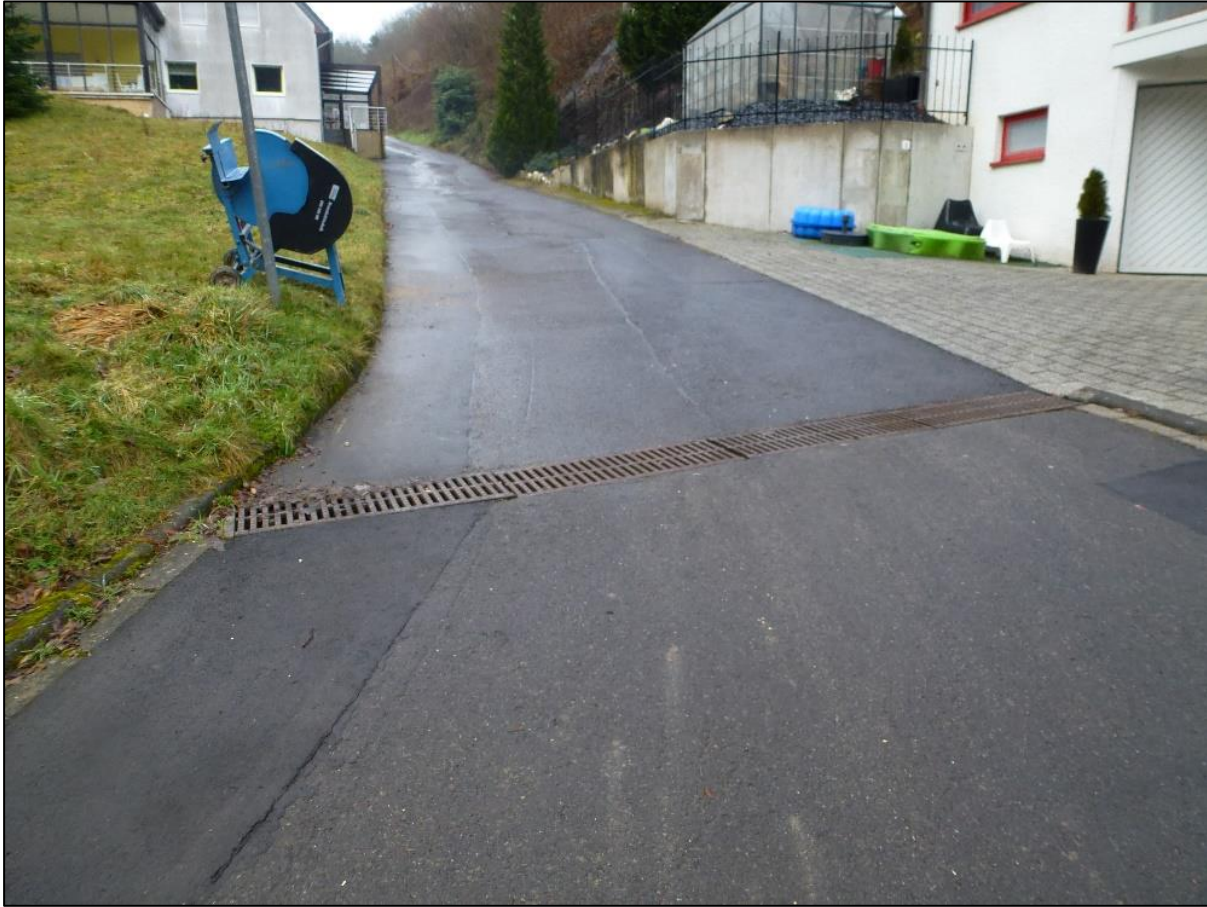
Abbildung 41: Einlaufrinne im Kreuzungsbereich "Am Wasserwerk" und Wildbadstraße
