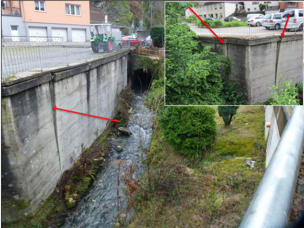
Abbildung 30: Riss in der Ufermauer
