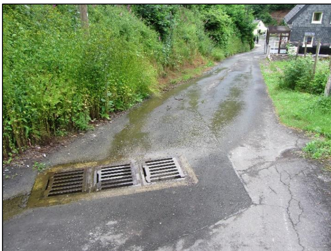
Abbildung 40: Einlaufbauwerk wird überspült.
