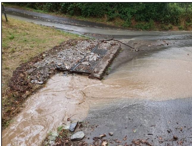
Abbildung 34: Zugesehtes Bauwerk verursacht Ausuferung des Gewässers (Foto: Kihm, 2020)
