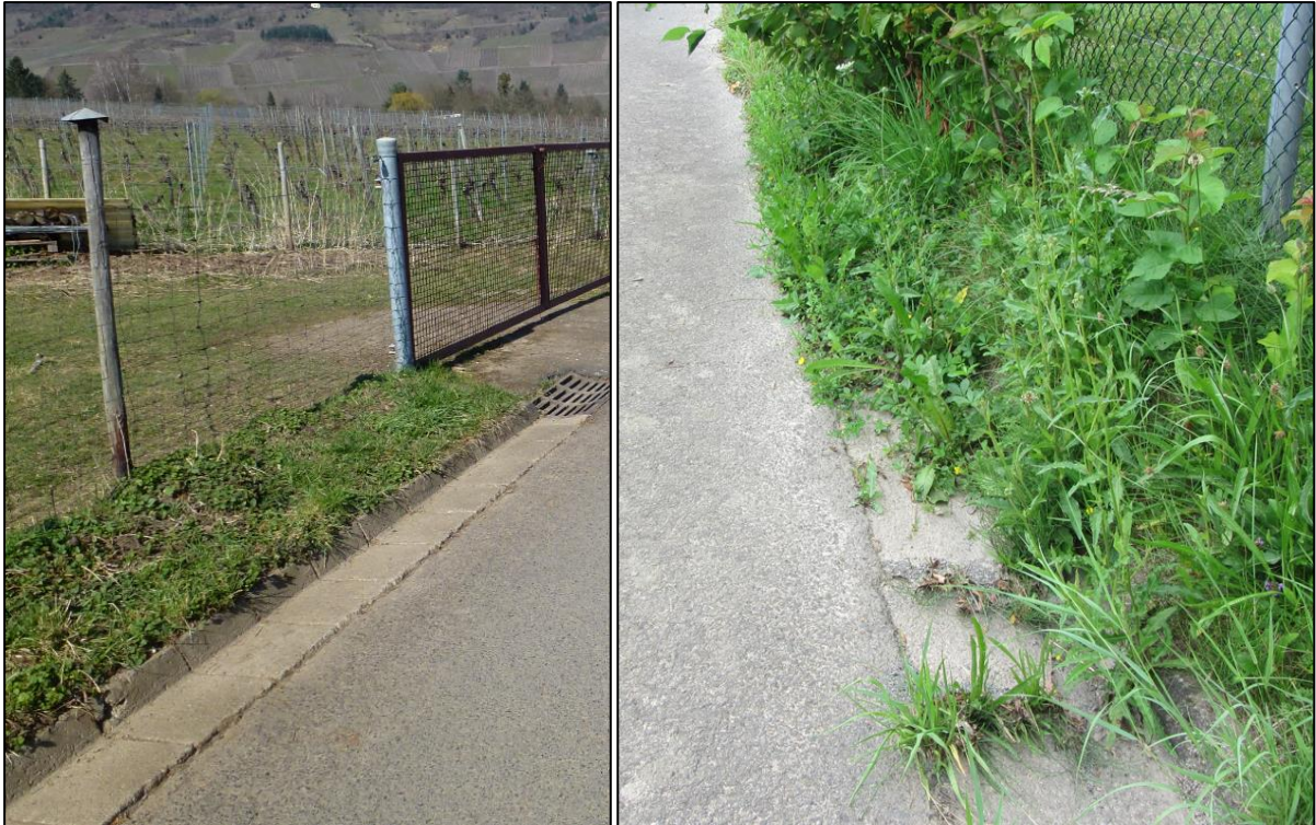
Abbildung 39: Gepflegte Rinne (links) & ungepflegte Rinne (rechts)
