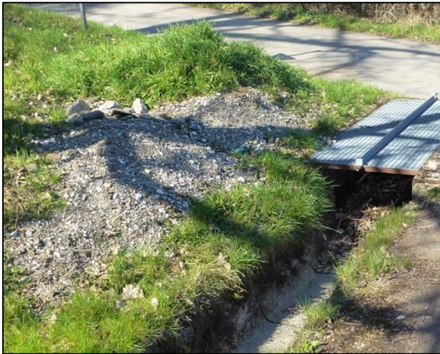
Abbildung 35: Schuttablagerung neben einem Einlaufbauwerk
