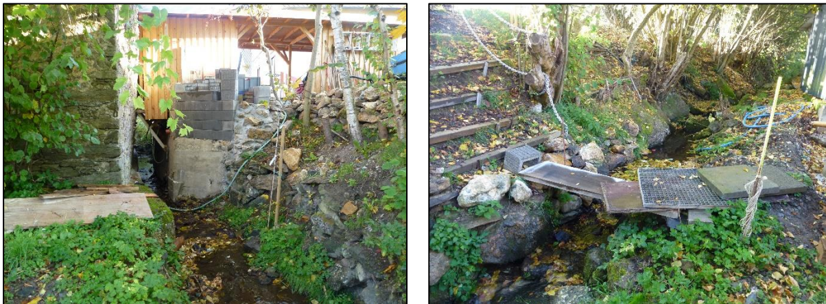
Abbildung 19: Beispiele für Bebauung und nicht genehmigte Brücken am und über das Gewässer
