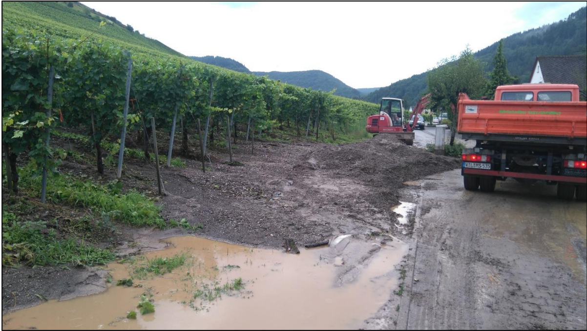
Abbildung 35: Materialtransport nach Starkregenereignis im Kräuterhausweg (Foto: Polch)
