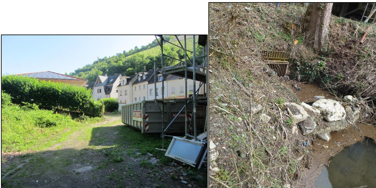
Abbildung 88: Zufahrtsweg zu der Bachverrohrung am ehemaligen Krankenhaus (links), Treibgut- und Sandfang an der Bachverrohrung (rechts)
