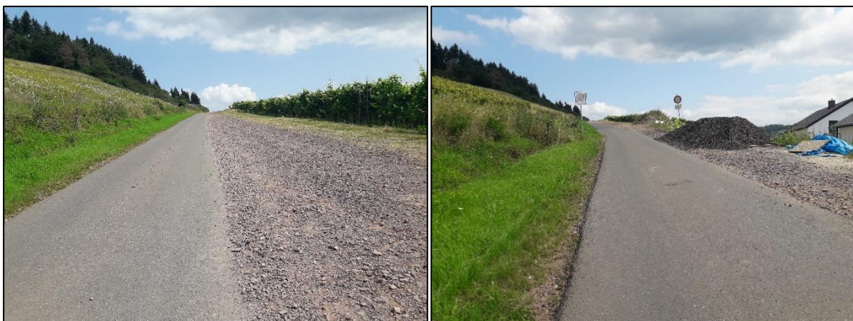
Abbildung 53: Seitenstreifen der Römerstraße mit Geröllablagerung
