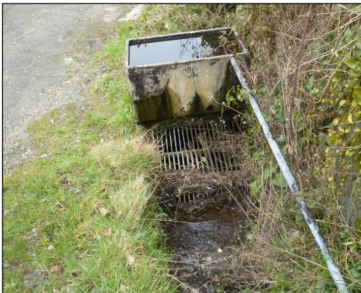
Abbildung 100: Ablagerungen im Entwässerungsgraben
