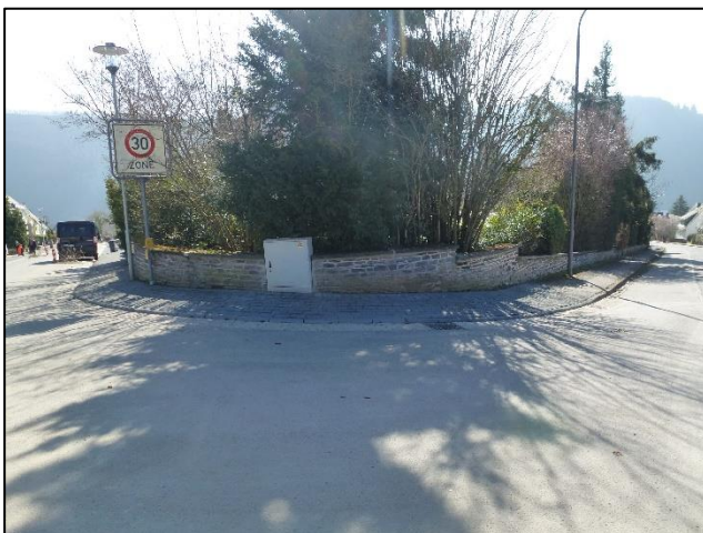
Abbildung 50: Grundstücksmauer im Verlauf der Tiefenlinie
