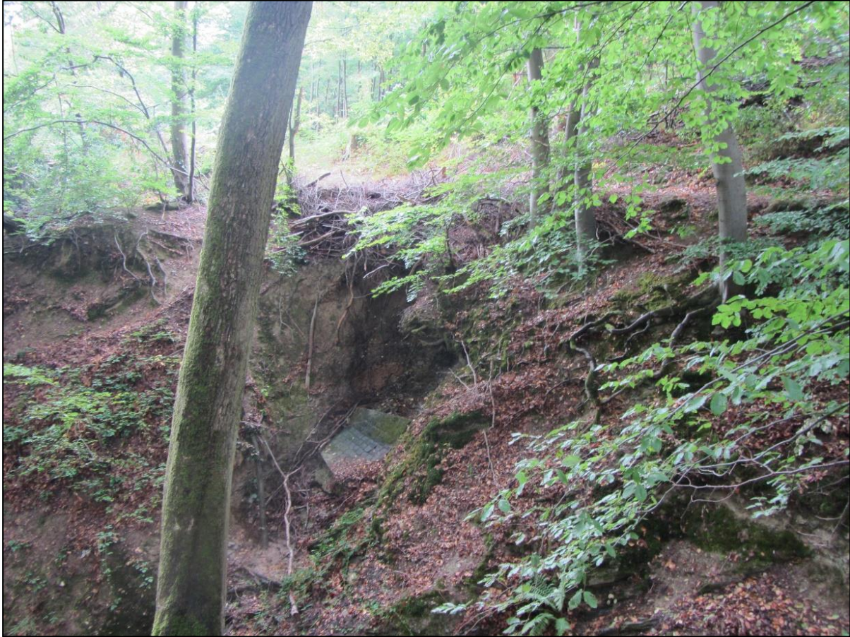
Abbildung 62: Eingebrochene Einleitstelle am Veitsgraben (Foto: September 2022)
