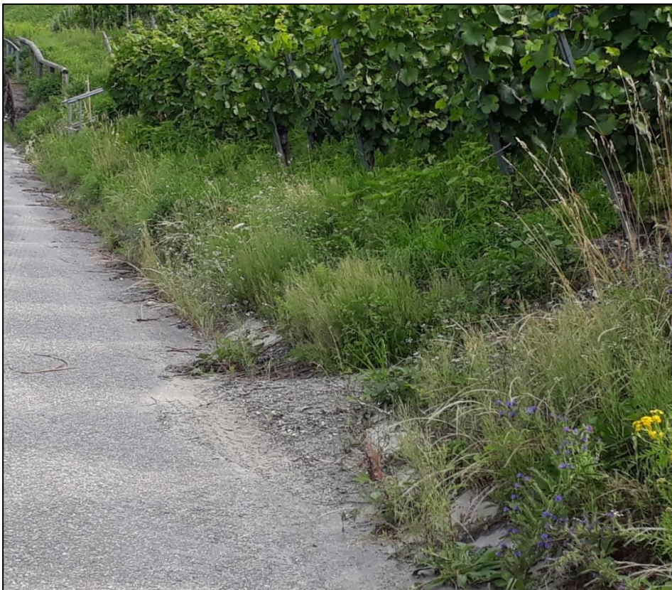
Abbildung 36: Geröll und Bewuchs auf der Abflusssrinne
