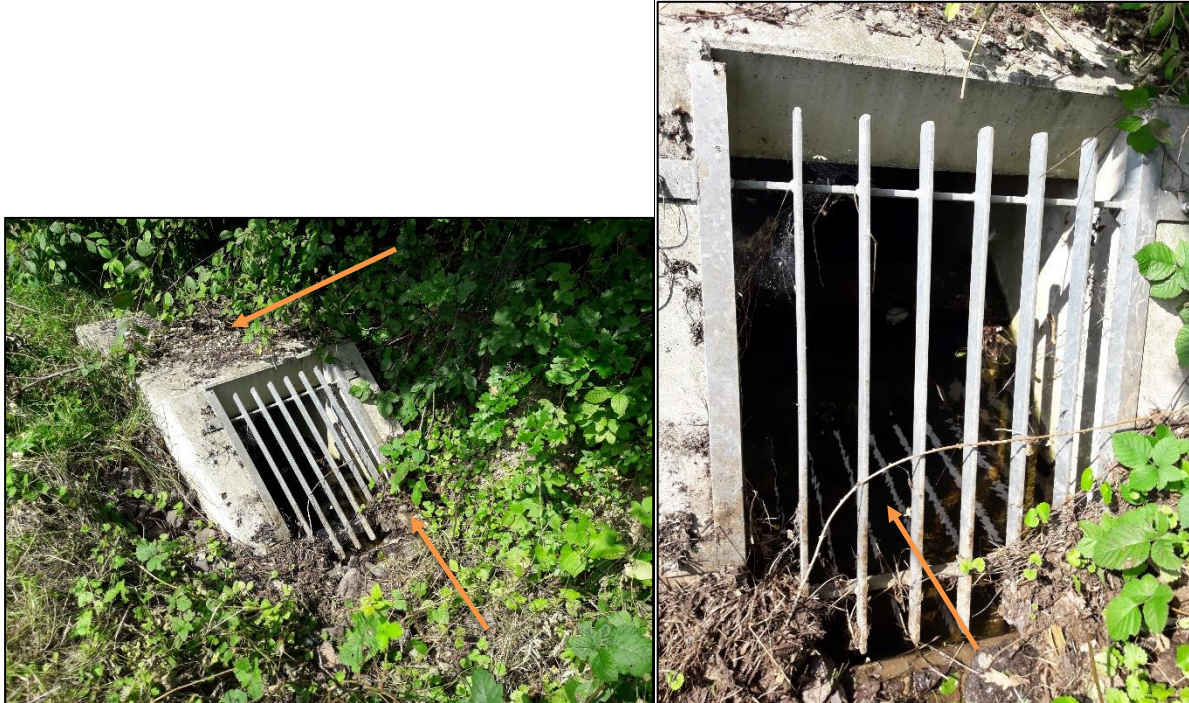
Abbildung 43: Einlaufbauwerk im Weggraben mit Treibgut und aufgestautem Wasser
